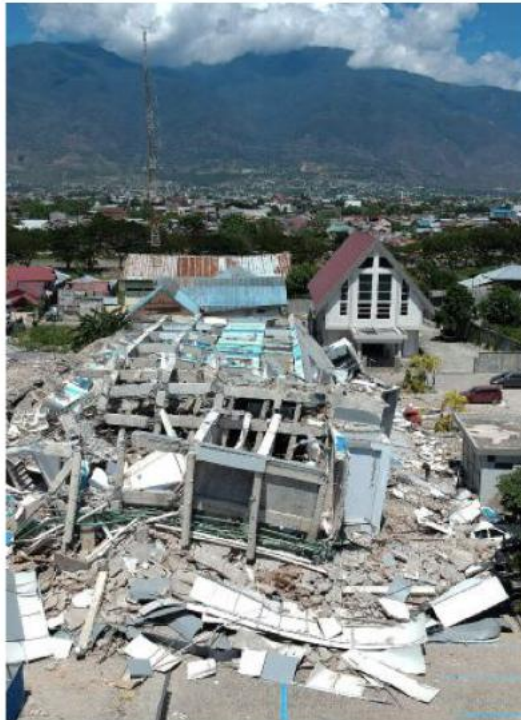
Quello che rimane di un hotel a dieci piani a Palu in Indonesia
