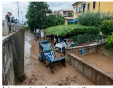
Anche ruspe e un bobcat al lavoro per portare via il fango
